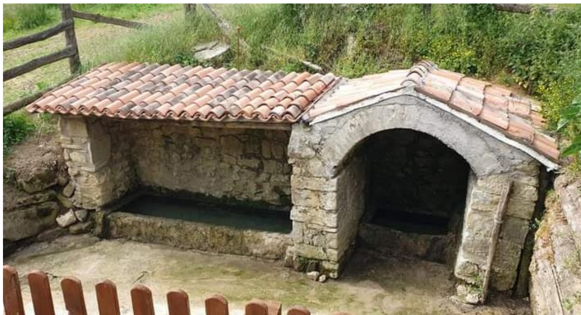
foto 31 . "fonte vecchia" dopo il terremoto del 2016.
