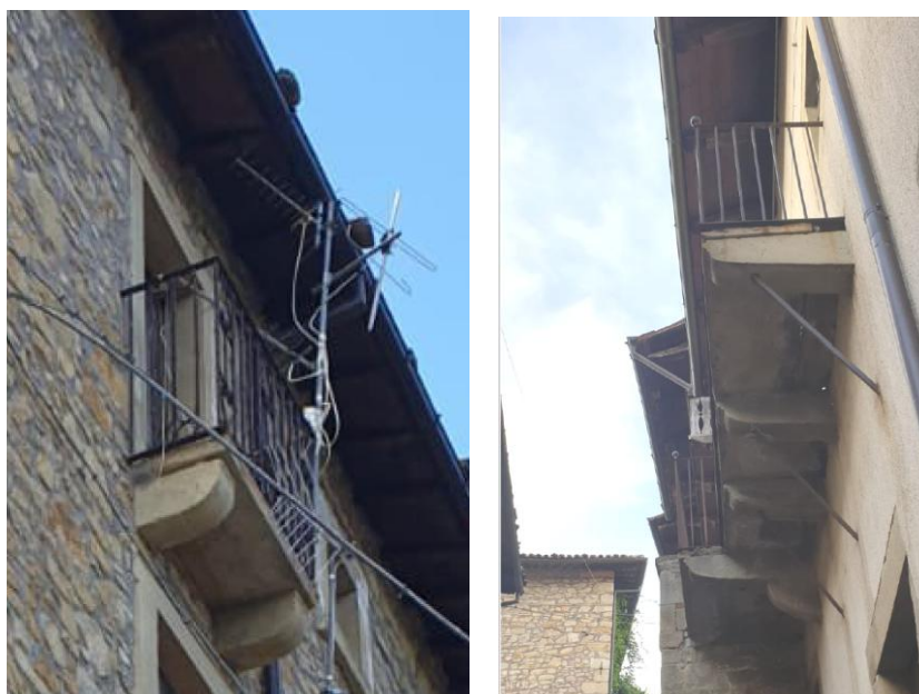
foto 54-55 balconi con mensoloni in pietra lungo il corso del borgo di Collemoresco (foto post sisma)
