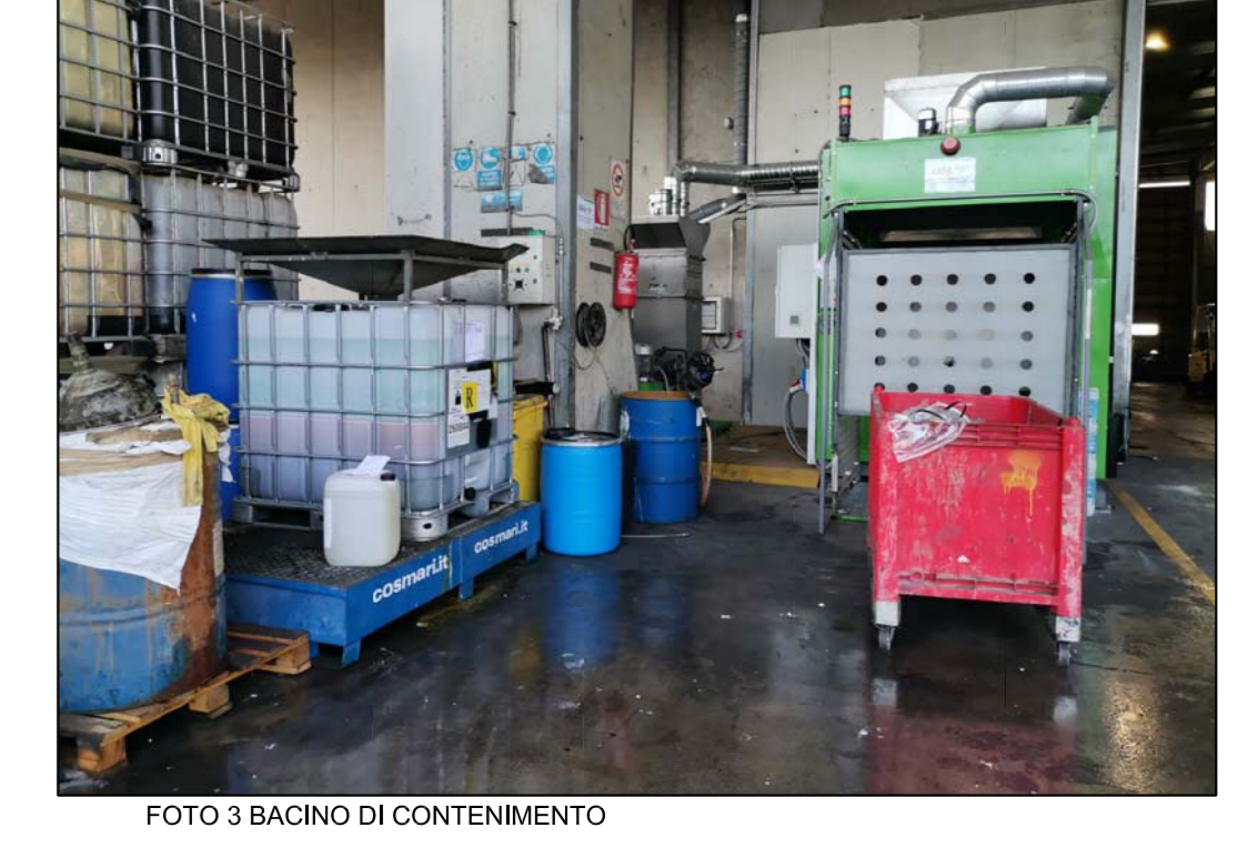
FOTO 3 BACINO DI CONTENIMENTO
