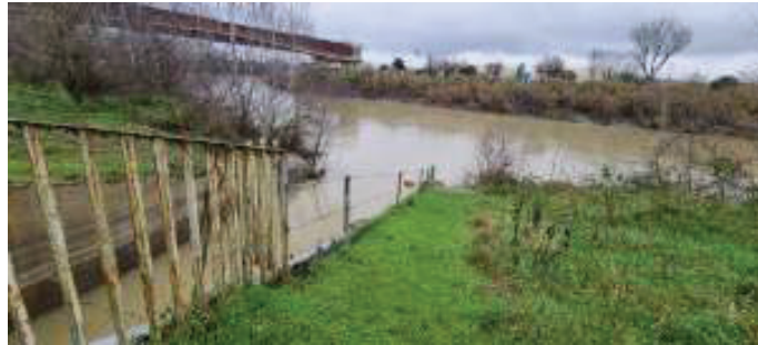
Figura 3 – vista laterale delle protezioni inserite a valle della recinzione dell’opera di presa per prevenire le cadute all’interno del canale di derivazione. La boa gialla dell’immagine sottende la centralina di monitoraggio.
