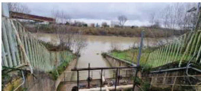
Figura 2 – vista frontale del canale di derivazione con la terminazione della recinzione anti-intrusione. La boa gialla nell'immagine è riferita alla centralina di monitoraggio
