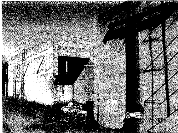
FOTO 40 - Impianto S. Marinella sud - Vasche Imhoff
