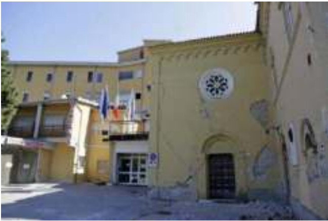
Facciata lesionata post terremoto della chiesa di Santa Caterina Martire
