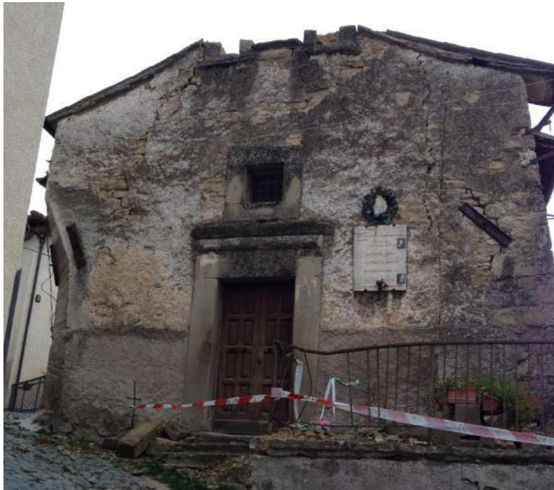
fig. 29: Chiesa di Santa Maria Assunta in Cielo dopo il terremoto del 2016. Le scosse del terremoto hanno fatto crollare il campanile a vela posto in asse con il portale. Il sistema di catene e tiranti, già presente nella chiesa, ha evitato altri gravi danneggiamenti.
