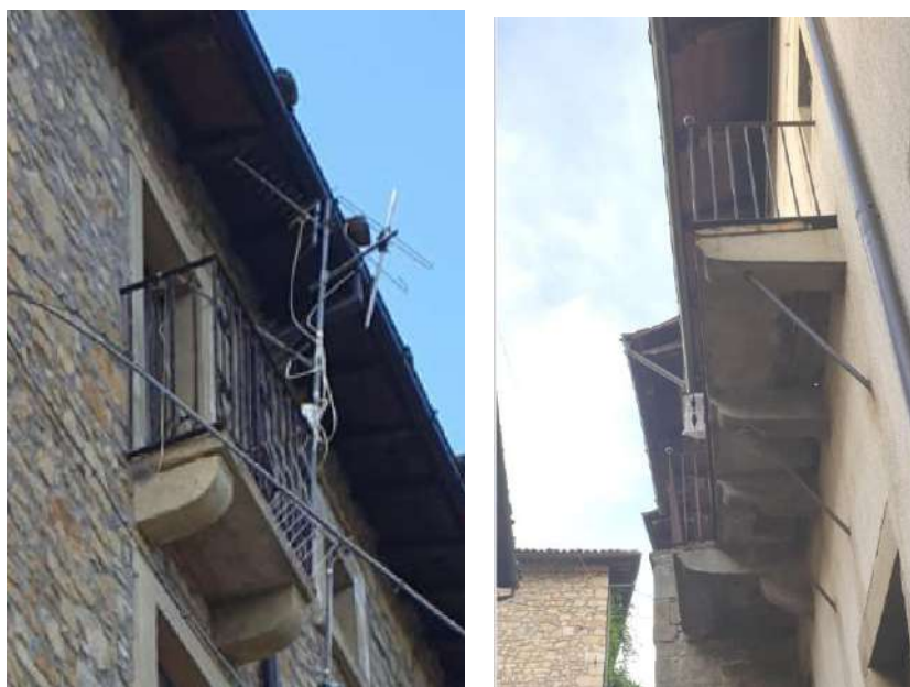
figg. 54-55 : balconi con mensoloni in pietra lungo il corso del borgo di Collemoresco (foto post sisma)
