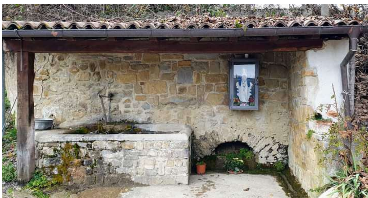
fig. 32: fonte "la trocca" dopo il terremoto del 2016.
